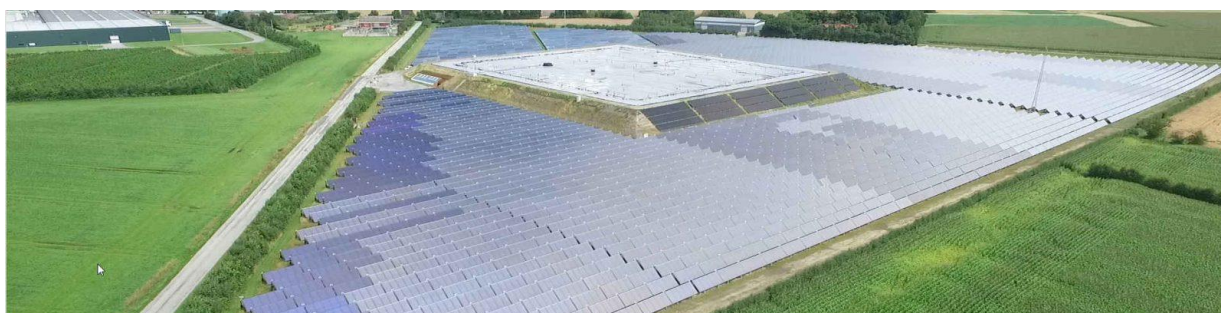
Figur 1: Billede af solfangeranlægget hos Gram Fjernvarme. Billedet viser rækker af solfangere, hvor solfangere er serieforbundne, og de parallelt forbundne solfangerrækker. Kilde: https://www.gram-fjernvarme.dk/firmaprofil/solvarme-i-gram/ .
