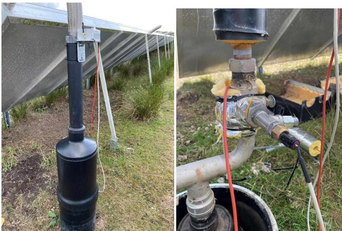
Figur 4: Sensoren monteret i anlægget. Elektronikken kan monteres på et vinkelbeslag. Proben til tryk skrues på et T-stykke udenpå trevejsventilen, og temperaturproben monteres udenpå metaldelen af standerrøret med termisk pasta og aluminiumstape og isoleres bag et stykke rørskål.
