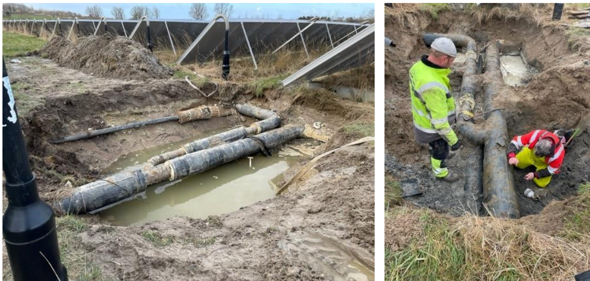
Figur 3: En underjordisk lækage på Sydfalster Varmeværk, hvor meldetråden samtidig var knækket, gjorde det besværligt at lokalisere lækagen.
