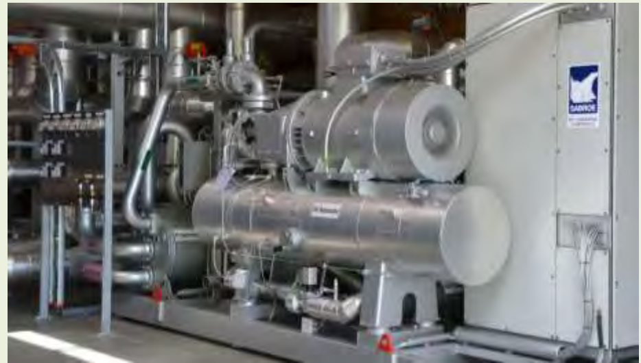
Højtryksanlæg ca. 90° C
