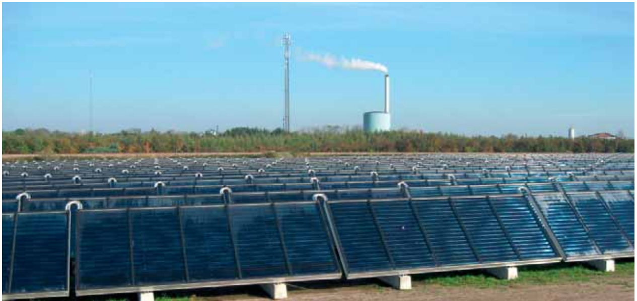
10.000 m 2 solvarmeanlæg er indviet i Oksbøl på den jyske vestkyst. Anlægget forventes at levere 16 procent af det årlige fjernvarmeforbrug i byen. Foto: Oksbøl Varmeværk.
