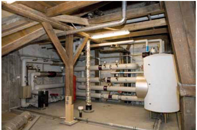
Efter konverteringen af fjernvarmen på Amalienborg er den dampcentral, der fordelte varmen til hele slottet, erstattet af decentrale varmecentraler i de enkelte palæer. Udskiftningen af varmesystemet forventes at give en besparelse på 17 procent. Foto: Christina Hauschildt.
