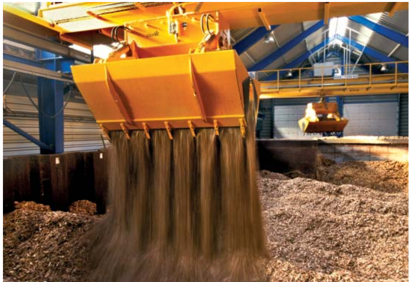
Forskningsprojekter, der berører fjernvarme, kan finde støtte i mange forskellige fonde. Eksempelvis har et projekt, der handler om at udarbejde en national handlingsplan for udvikling og demonstration inden for kraftvarme fra fast biomasse, fået støtte fra EUDP. Foto: Jørgen Schytte.
